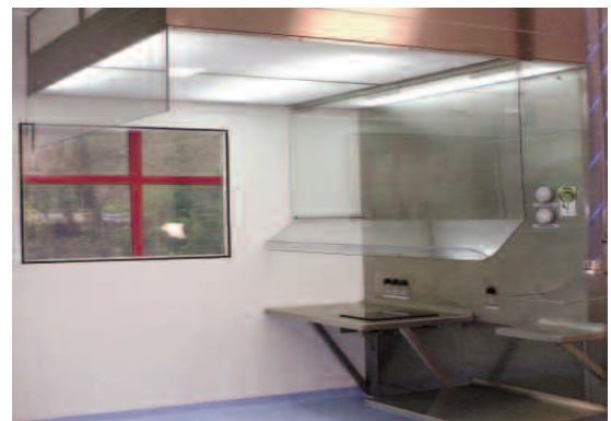
Cabine industrie pharmaceutique
